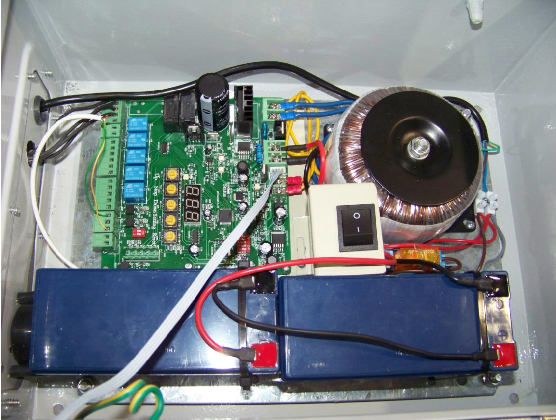
Foto del cuadro de control.
