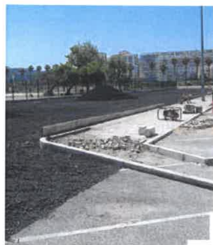
Proprietário: C. M. de Almada Empreiteiro: C. M. de Almada Local: Costa da Caparica Tipo de aplicação do ASIC: Camada de sub-base e base
